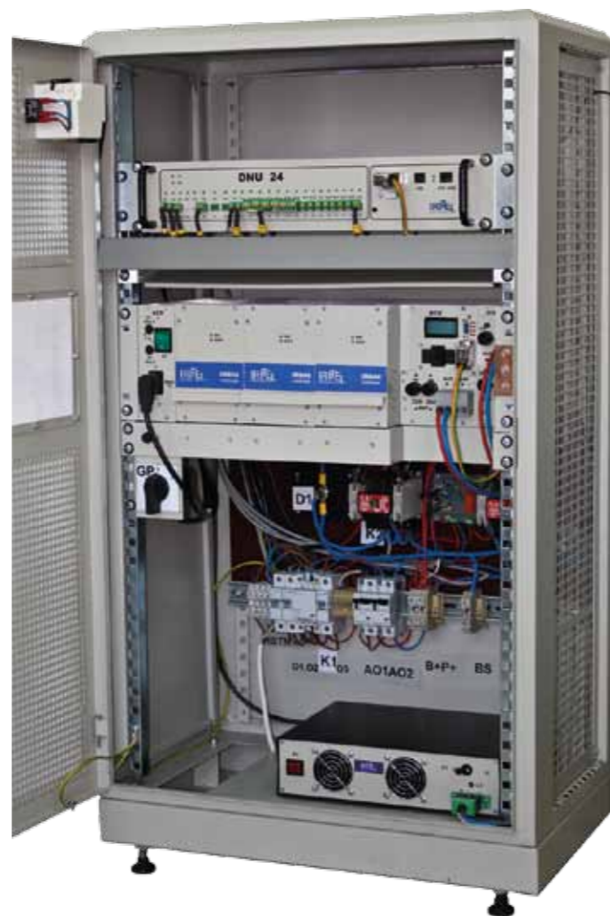
SN12/110 sa pratećom opremom, dodatnom granom za punjenje baterija i uređajem za daljinski nadzor i upravljanje (DNU24) u kabinetu od 1000 mm
